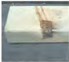
Taché et endommagé
